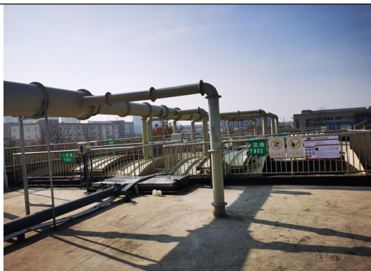
污水处理站上方废气收集管道
