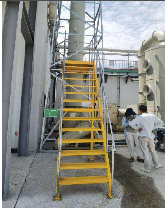
废气排放口 (DA001)
