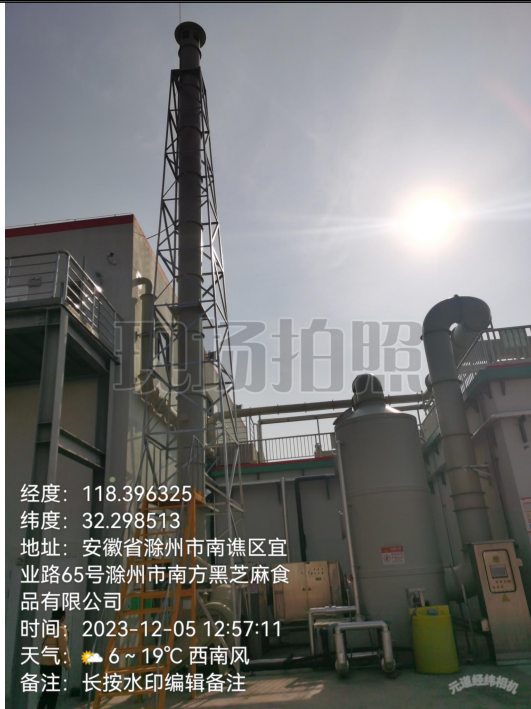
水喷淋+UV 光氧+活性炭吸附箱+15m 高排气筒 (DA001)
